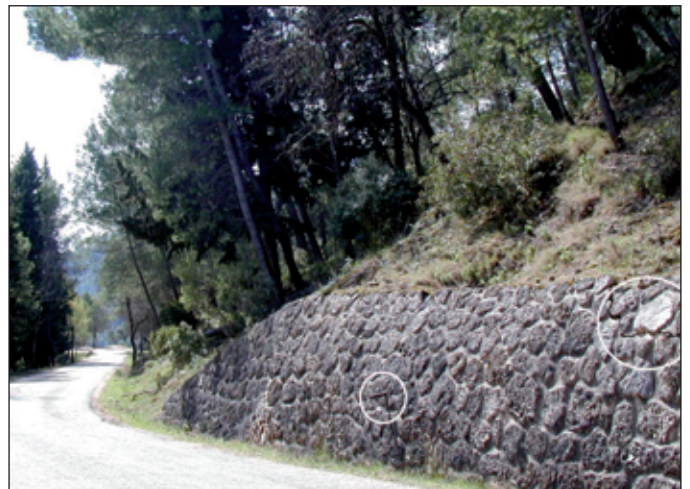
Fig. 4 - (a) - Escarpe de desprendimientos en cuarcitas (embalse de Guadalmena). (b) - Cicatriz semicircular y masa desplazada (embalse del Tranco de Beas). (c) - Inclinación de árboles por reptación. Muro agrietado y con drenaje Fig. 4 - (a) - Rock falls and cliff in quartzites (Guadalmena reservoir). (b) - Surface rupture and displacing materials (Tranco de Beas reservoir). (c) - Creeping processes and tilted trees. Cracks and drainage in the wall
